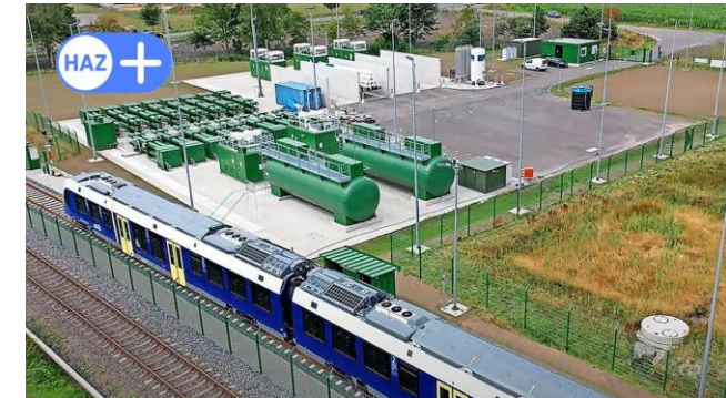
Vodíková čerpací stanice
